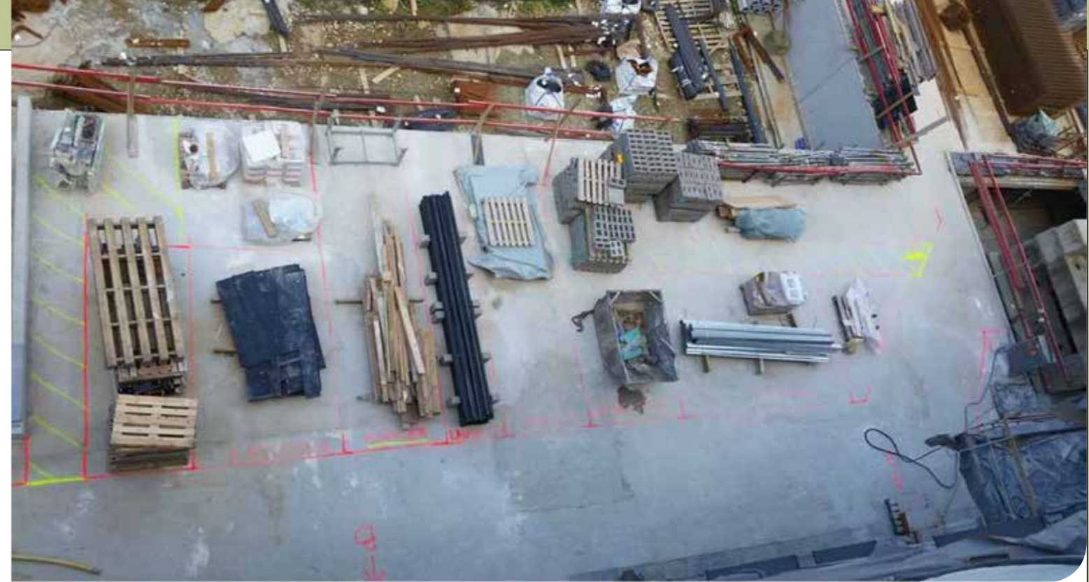
Een goed ingerichte bouwplaats waar alles zijn plaats heeft en waar kleuren onmiddellijk de weg wijzen. Ook dat is Lean Management!
